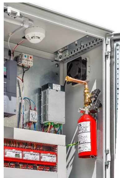
Rys. 12. SUG wewnątrz centrali.
