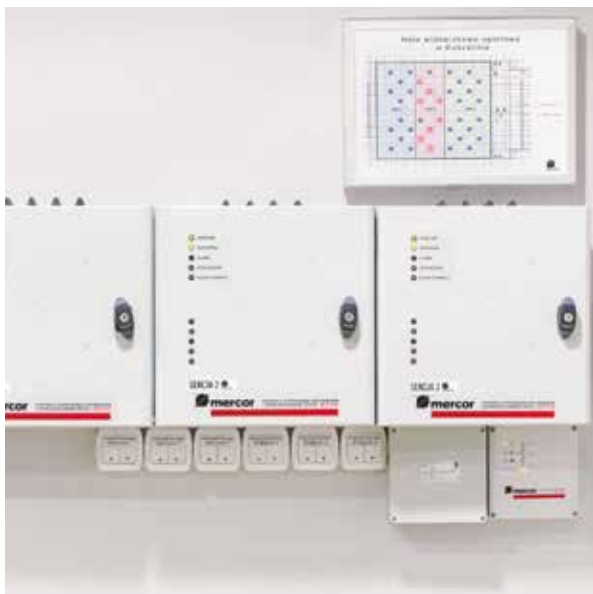
Rys. 2 Przykładowe zastosowanie elektrycznych systemów sterowania oddymianiem
