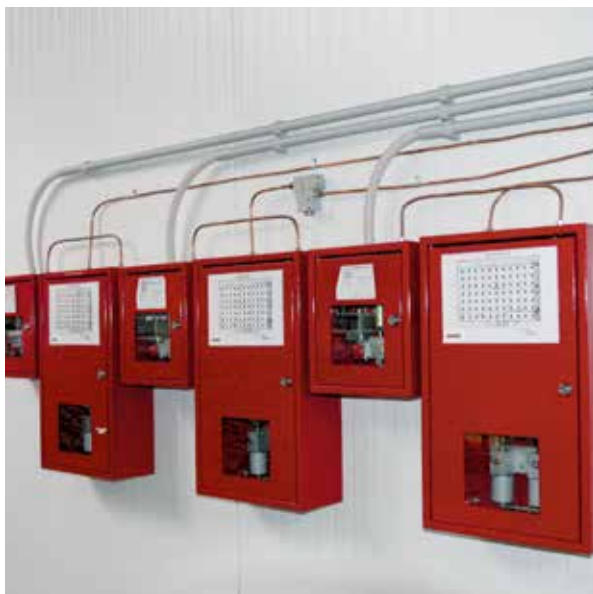
Rys. 1 Przykładowe zastosowanie pneumatycznych systemów sterowania oddymianiem
