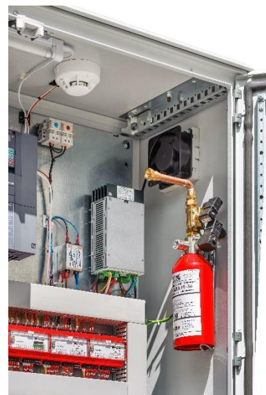
Rys. 12. SUG wewnątrz centrali.
